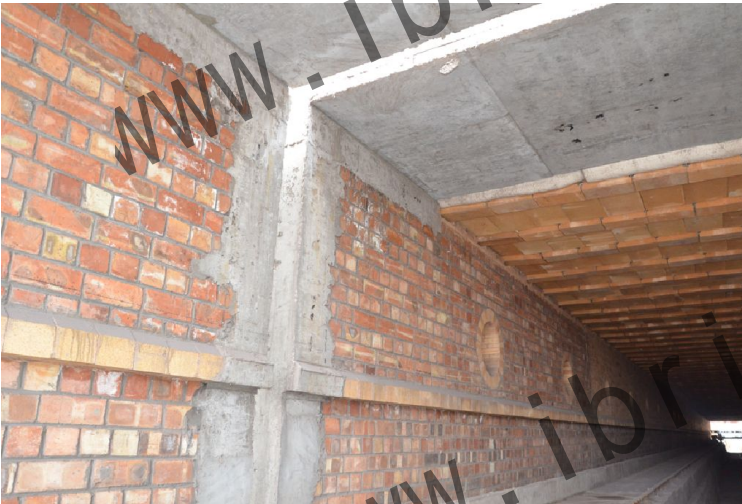
隧道窑只在焙烧带的窑顶及窑体侧墙使用耐火砖；在保证窑体质量的前提下，节约窑体构造成本。
