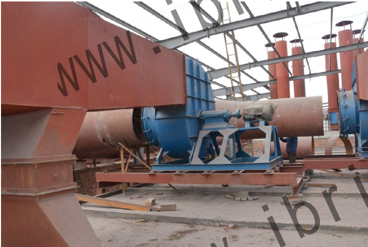
窑顶上的管道将收集的烟气排除，以及收集的余热供给干燥室
