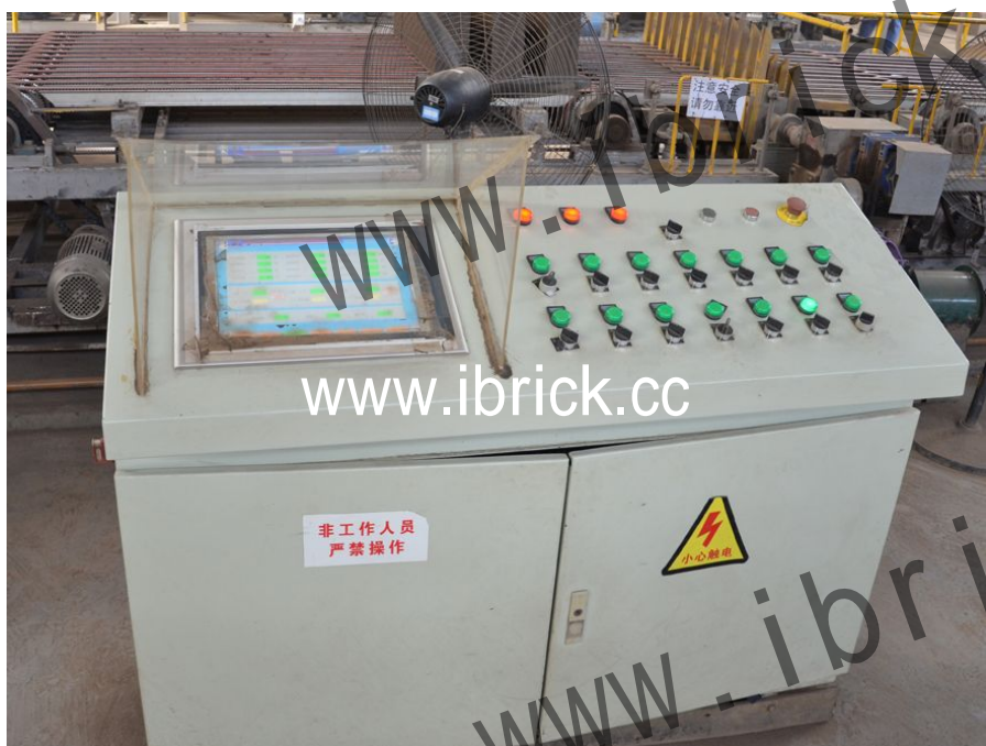
分运坯控制系统操作台
